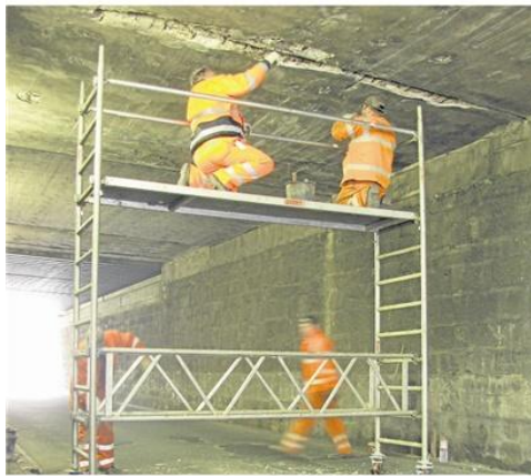
Zuletzt hatte sich unter anderem an der Eisenbahnbrücke über die Höingstraße der Beton gelöst. ■ Foto: Archiv
