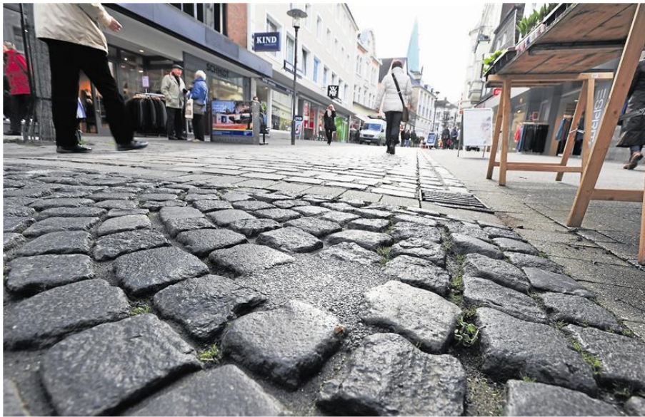
Die mit breiten Fugen verlegten Natursteine bilden böse Stolperfallen, und wenn sich ein weiterer Stein gelockert hat, setzt die Stadt zum Flicker Kalth Asphalt ein. Der Wunsch nach einem Neubau ist verständlich. Ob er realistisch ist, wird sich zeigen. ■ Foto: Archiv
