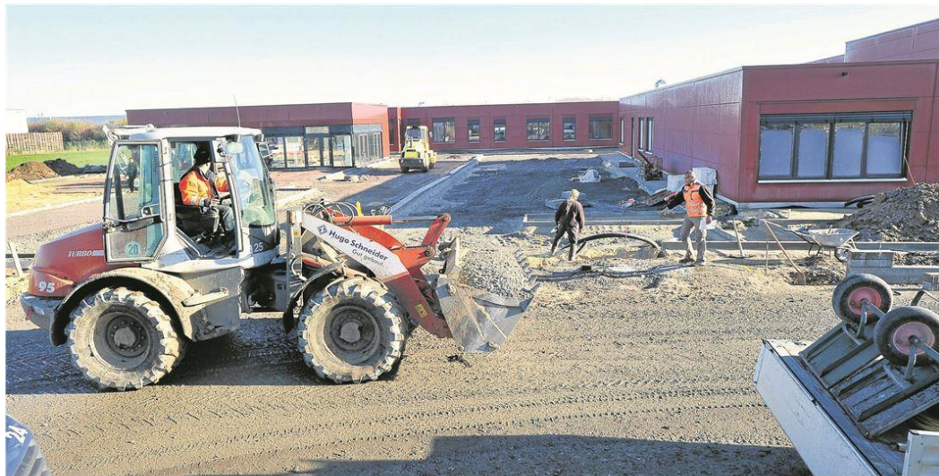
In der Osterweiterung des Induparks war eine Perthes-Behindertenwerkstatt Ende 2013 eine der letzten Ansiedlungen (Bild). Die Wirtschaftsbetriebe planen, die Osterweiterung um weitere 70.000 Quadratmeter auszudehnen. Ob das geht und mit welchem Aufwand, ist offen. Die Politik ist mehrheitlich dafür. Foto: Archiv
