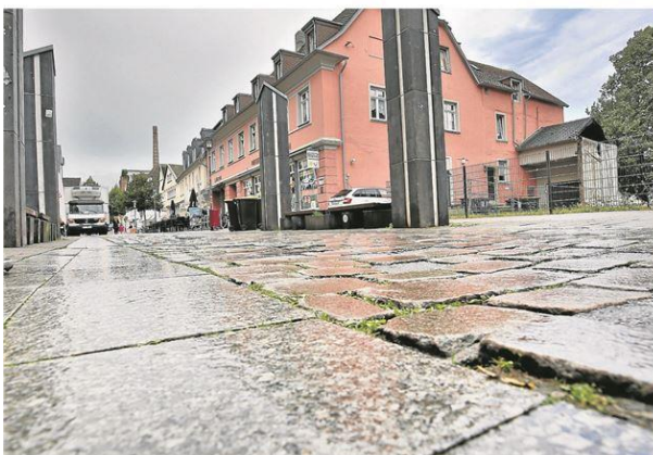
Dass das Pflaster der „Bummelmeile“ teils marode und für Fußgänger gefährlich geworden ist, war ein ausschlaggebender Grund für den Beschluss, die Fußgängerzone zu sanieren.
