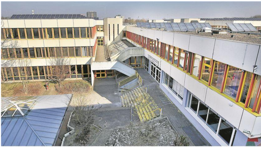
Der Gebäudekomplex des Schulzentrums Nord ist 43 Jahre alt. Die notwendige Sanierung läuft seit sieben Jahren, und die nächsten Maßnahmen werden teurer als geplant. Sie sind aber nicht aufschiebbar. FOTO: DRAWA
