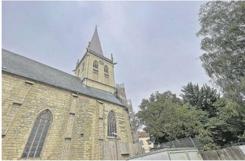
Die Sanierung der Evangelischen Stadtkirche kostet mehrere Millionen Euro – darin auch Mittel der öffentlichen Hand.
